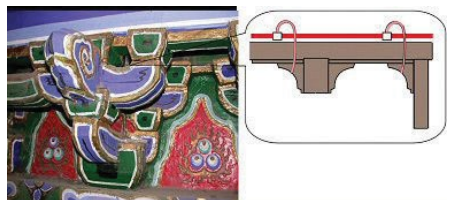
細いキャピラリーチューブは、配管から垂らして装飾の中に隠すことができます。チューブは完全にカモフラージュするために塗装することも可能です。
